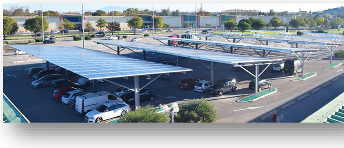
exemple d'ombrières de parking (Source Helexia)
